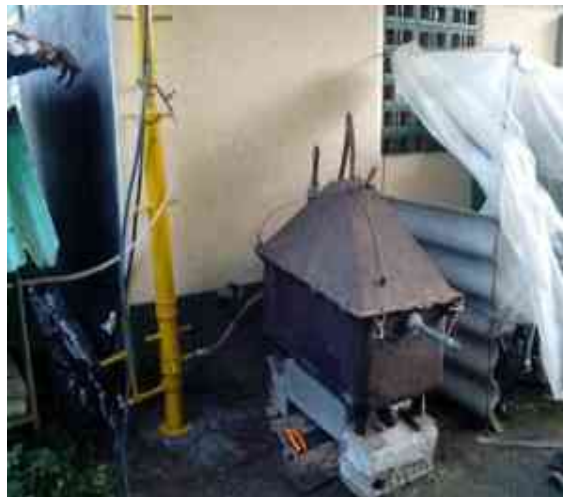
Nuevo destilador y nueva caldera en El Cábulo
