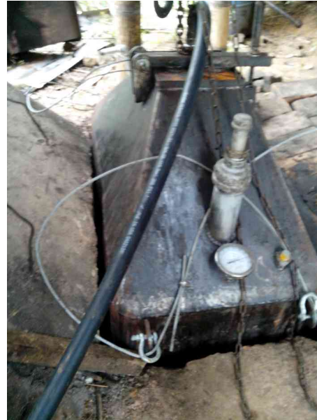
Caldera en hierro en su sitio
